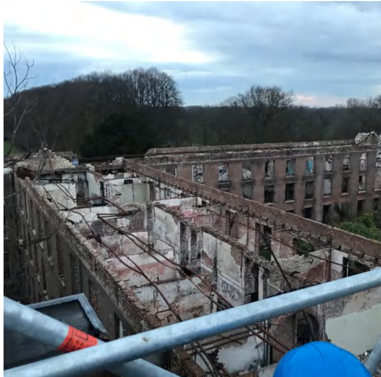
Uitzicht op de bouwresten van de u-vorm vanaf het tijdelijke uitkijkpunt op het landgoed Haarendael
